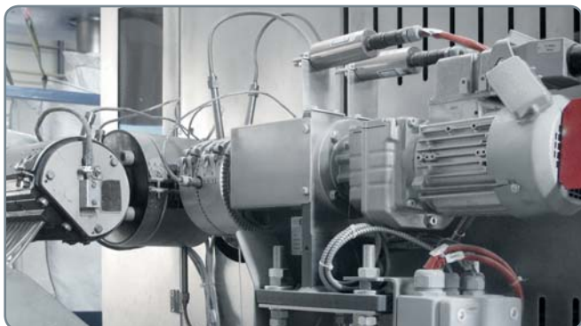
Integrierte Online IV-Messung
